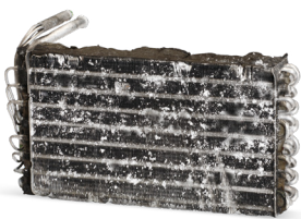
Sin mantenimiento del sistema de A/A
