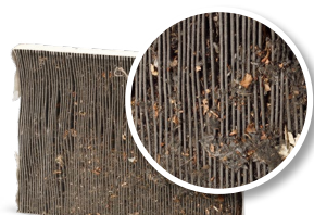
Sans maintenance du système de climatisation
