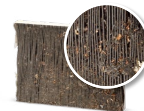
Sin mantenimiento del sistema de A/A
